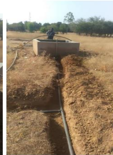
Vue des conduites
