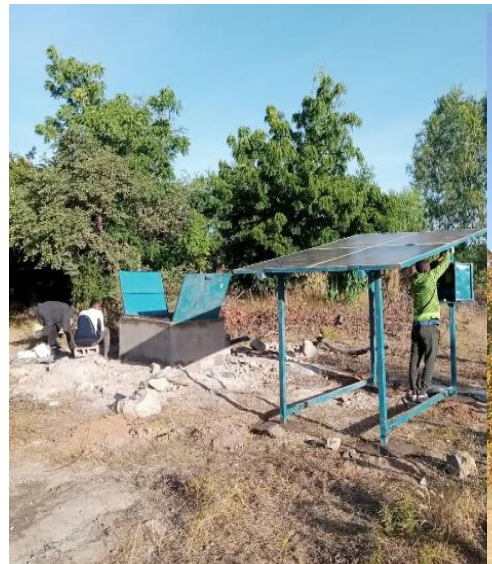
Forage équipé d'un système d'exhaure
