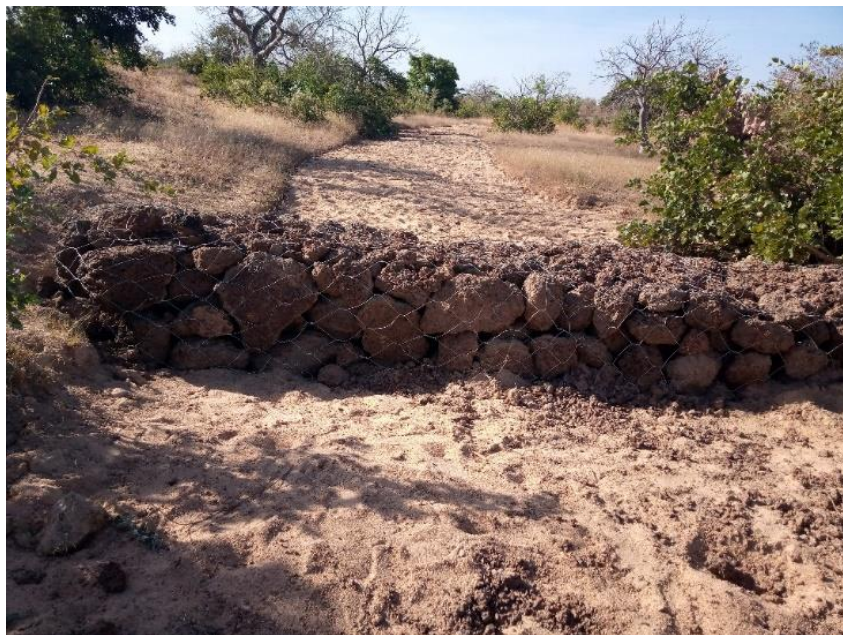
Photo 9 : digue filtrante (piège à sédiment) sur le cours d'eau alimentant le barrage
