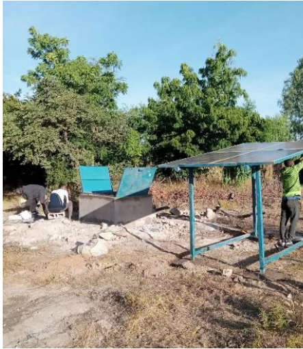
Photo 12 : Forage équipé d'un système d'exhaure solaire
