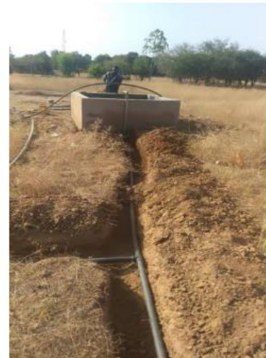
Photo 14 : Vue des conduites
