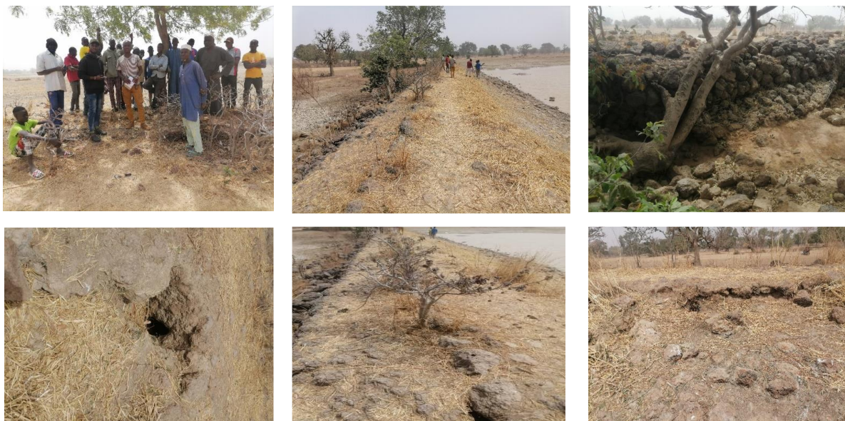
Photo 18 : constat de l'état des dégradations du barrage de Souka
