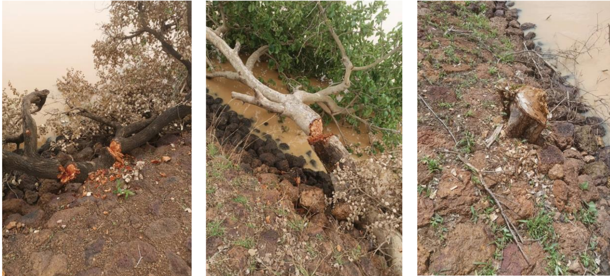
Photo 11 : découpage des arbres et arbustes sur la digue du barrage de Kouri
